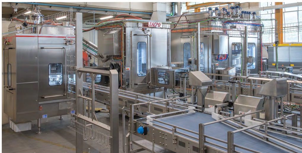
Dettaglio della linea di preparazione e riempimento realizzata da Zacmi (Fonte Zacmi)
