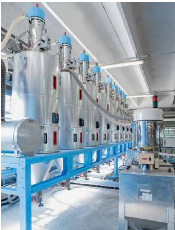
Il reparto di stampaggio a iniezione è dotato di un moderno sistema di alimentazione e trattamento della materia prima
