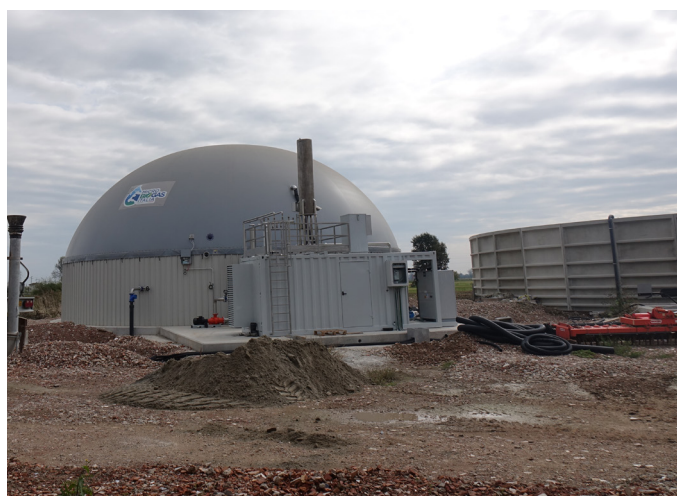
Il nuovissimo impianto a biogas che verrà utilizzato per generare elettricità e calore, riducendo così i costi energetici aziendali
