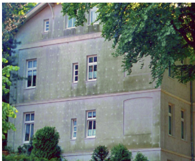
1. Tipico degrado algale su facciata con ETICS (External thermal insulation composite systems) – (Germania).
