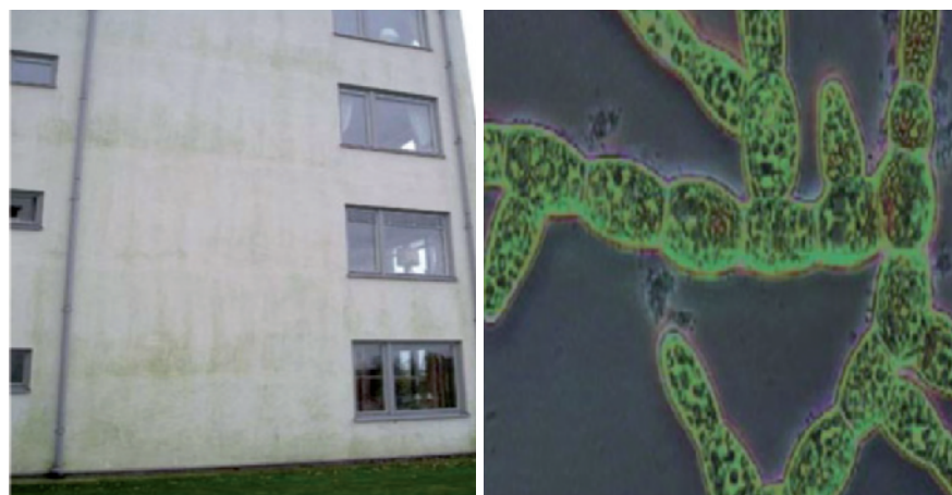
5. Contaminazione biologica da parte di microalghe su una facciata leggera.
