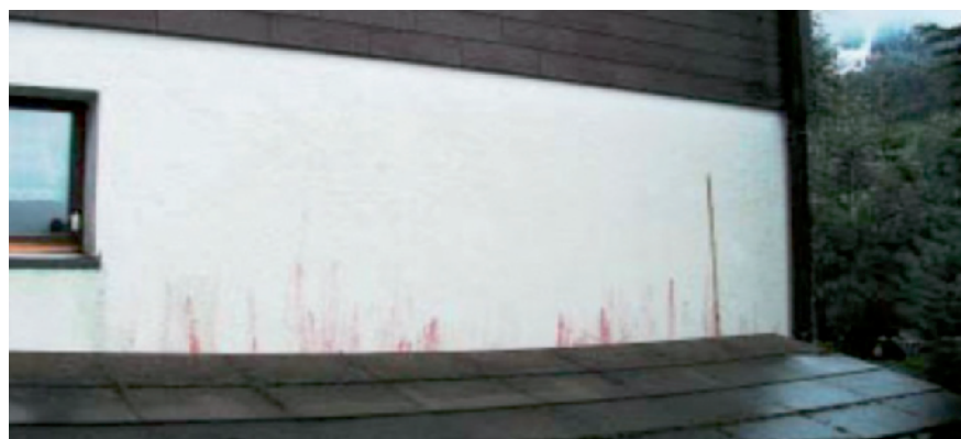
2. Contaminazione algale su una parete per accumulo di acqua in prossimità dell'innesto parete-tettoia. Il degrado raggiunge un'altezza di 1,60 m.
