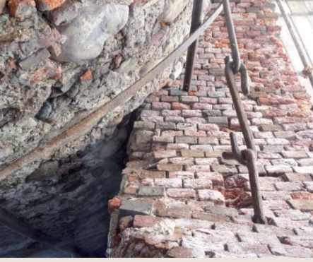
Prima dei lavori. La fornace più antica presentava uno stato fessurato diffuso e una tendenza al ribaltamento della muratura nel piano alto. La fornace più recente, quella posta a levante, era in migliori condizioni presentando solo un ridotto quadro fessurativo sul lato a levante.
