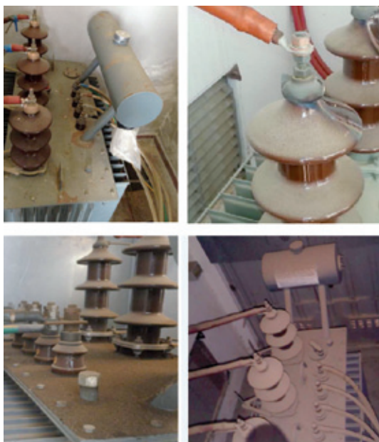
Figura 4.7: Condizioni di pulizia degli isolatori
