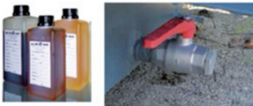
Figura 4.3: Prelievo di campioni di olio dal trasformatore
