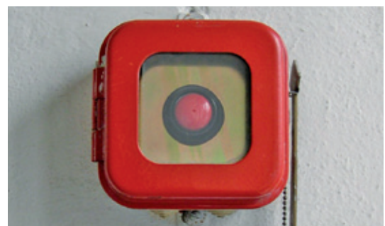
Figura 1.8: Pulsante di sgancio per apertura DG cabina
