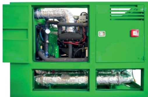
Impianto 40 kWe - 71 kWt vista interna
