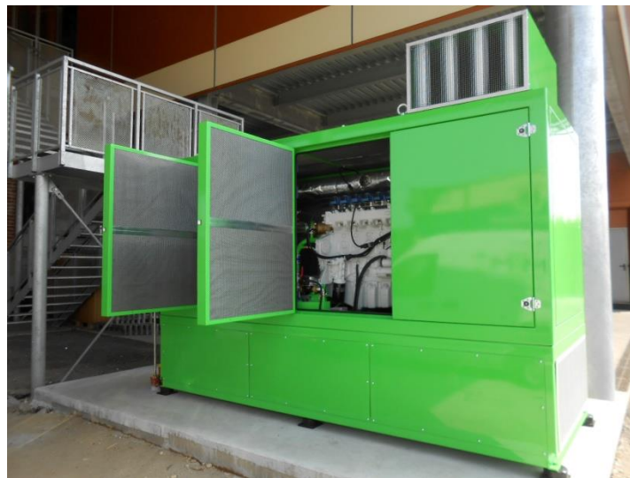
Impianto 65kWe Gas Naturale SALUMIFICIO (NO)
