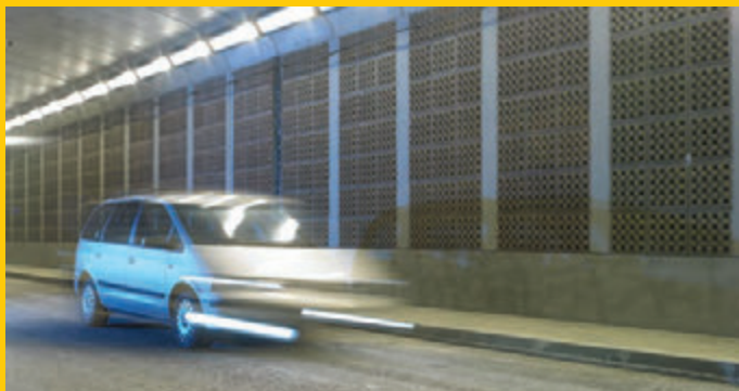
Rivestimento fonoassorbente in una galleria a Torino.
