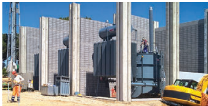
Bonifica acustica nella Stazione Terna di Roma.
