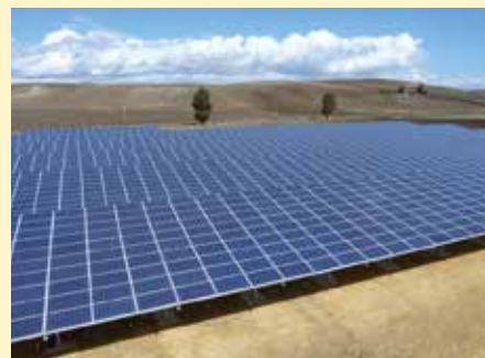
L'impianto fotovoltaico nello stabilimento di Enna.
